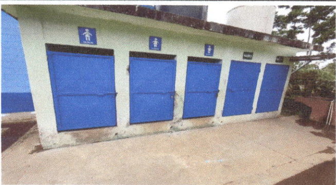
Foto 3: Puertas de metal.
